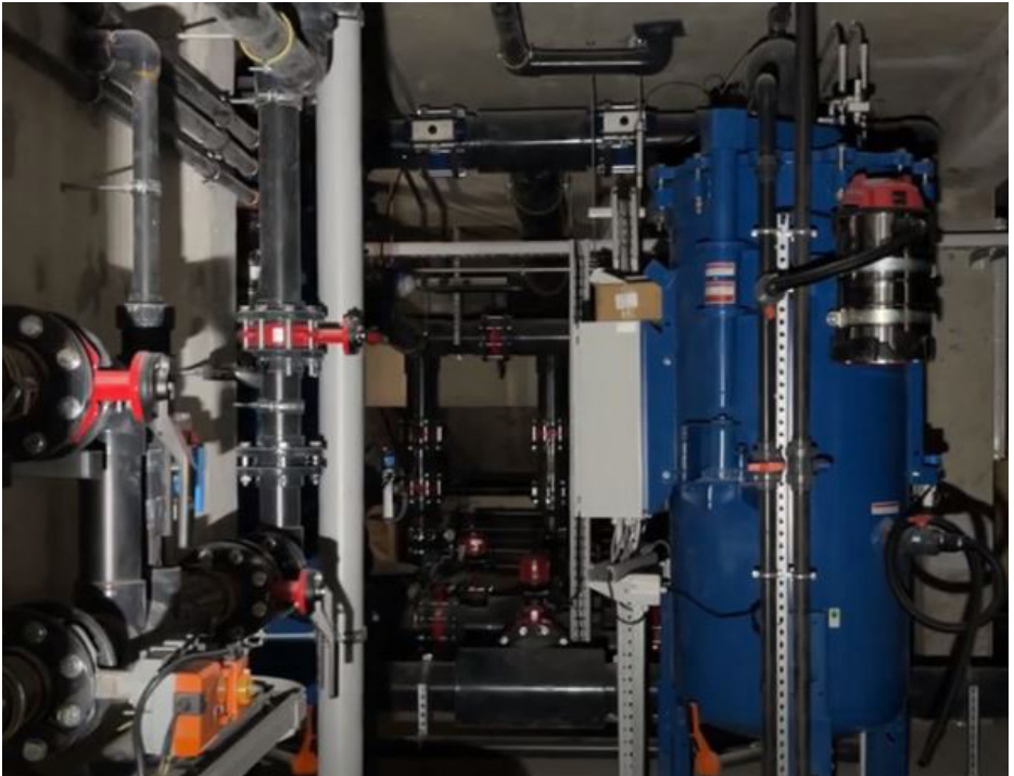
Les nouvelles installations techniques de filtration de l'eau
