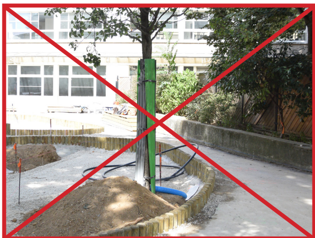
Protection inadaptée Bardage PVC apposé directement sur le tronc
