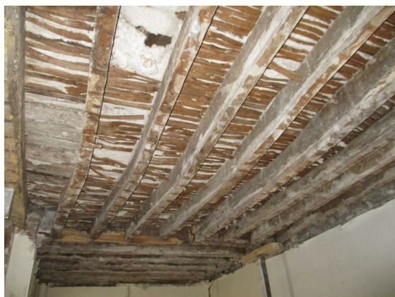
[ill. 3] Déformation d'une poutre en bois
